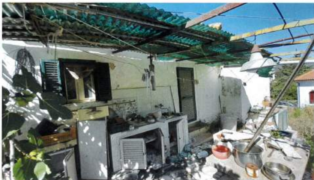
Prospetto lato Sud non sono presenti elementi architettonici di valore, sono presenti diverse superfetazioni ( tettoia- casotti )
